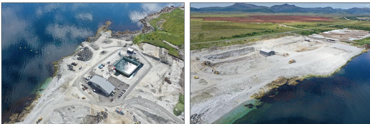
Figur 1-1. Andøy Industripark Kvalnes under utbygging. Administrasjonsbygg og oppstartsbasseng t.v. Område for hovedanlegg t.h. (Foto: Andfjord Salmon AS, juli 2022).
